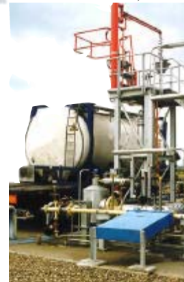
Estación de Carga de camiones de alta precisión con el medidor RHM 60 FNT, medida metrológica.
