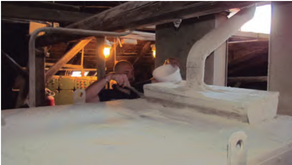
FIGURA 5. Capa de polvo asentada en la estructura del molino de trituración
